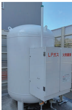
茨城工場LPGガス設備
