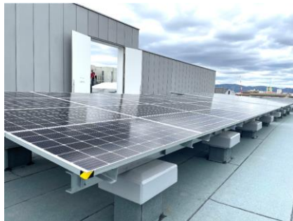
↑屋上に設置した太陽光パネル
